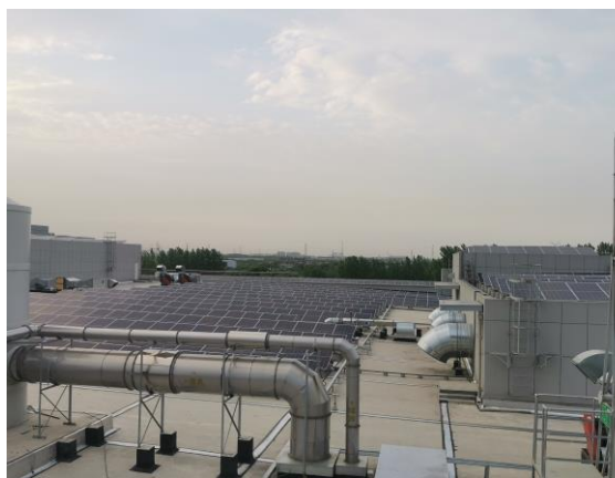
屋顶分布式光伏发电板照片
