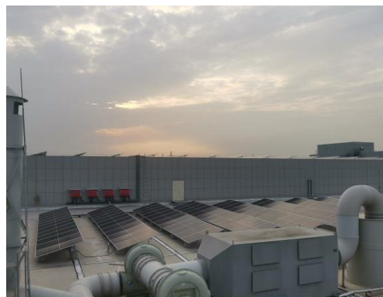
屋顶分布式光伏发电及逆变系统
